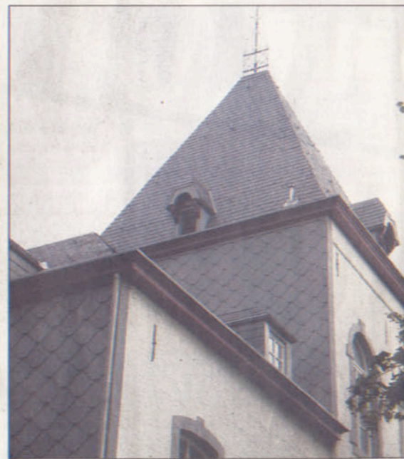
Dieser ehemalige Bauernhof erhielt eine neue Schiefer-eindeckung. Die vorgehängte Fassade wurde durch neue Titanzink-Rauten ersetzt. Foto: Lothar Wählen
